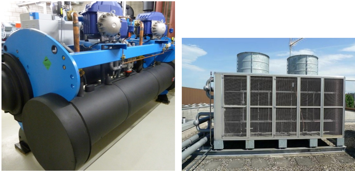
Abb. 1: Wärmepumpe zur Nutzung der Abwärme und Kühlturm
